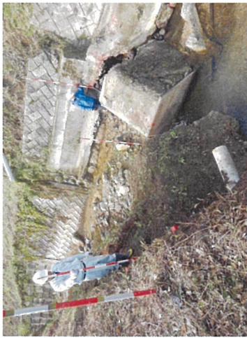
頭首工崩壊(奥出雲町)
