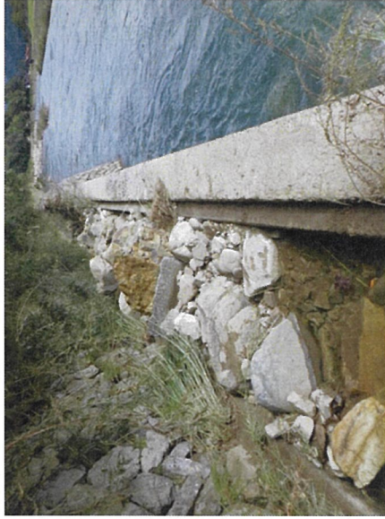
農業用水路土砂堆積(吉賀町)
