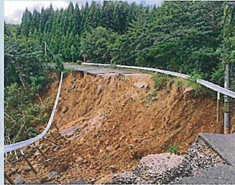
町道の崩落（隠岐の島町久見地区）
