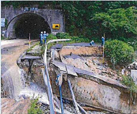
市道の崩落（雲南市吉田町）
