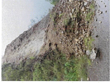
林道脇土砂崩れ(津和野町)
