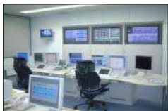
消防の指令装置関連設備
