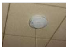
消防設備（感知器）
