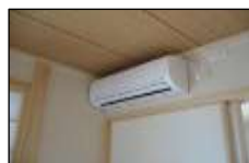
冷暖房（室内機）
