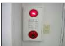
消防設備（報知器）
