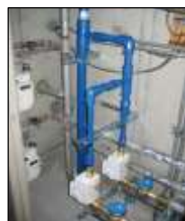
給排水設備（受水槽）
