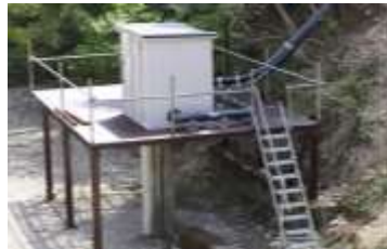
〈源泉ポンプの例〉
