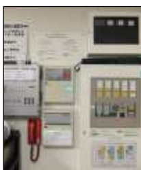
消防設備 （自動火災受信機）
