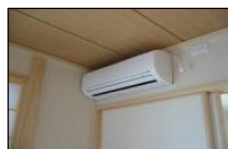
冷暖房（室内機）
