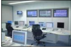
消防の指令装置関連設備
