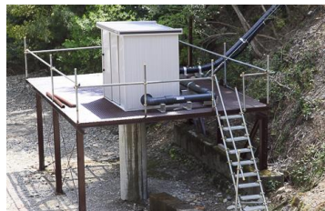
〈源泉ポンプの例〉
