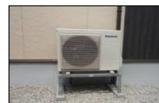
冷暖房（室外機）
