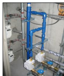
給排水設備（受水槽）
