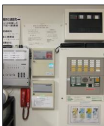
消防設備 （自動火災受信機）
