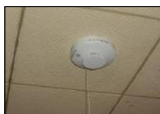
消防設備（感知器）
