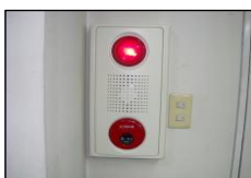
消防設備（報知器）
