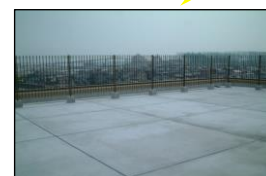
フェンス （屋上設置のもの）
